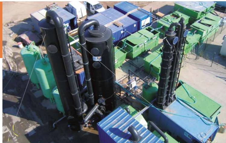
Blick auf die Grundwasserreinigungsanlage beim Projekt Leuna.
